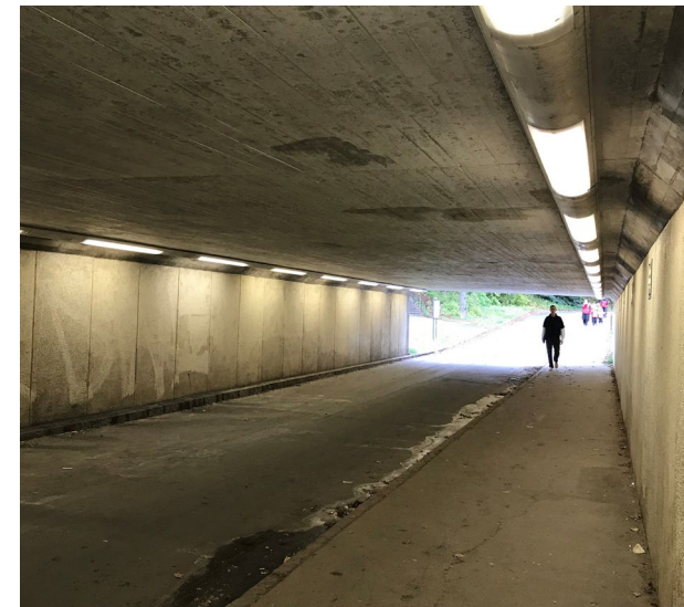
2. Gångtunnel i Räcksta med robusta armaturer som placerats för att skapa en god kontrastutjämning mellan inne och ute.
